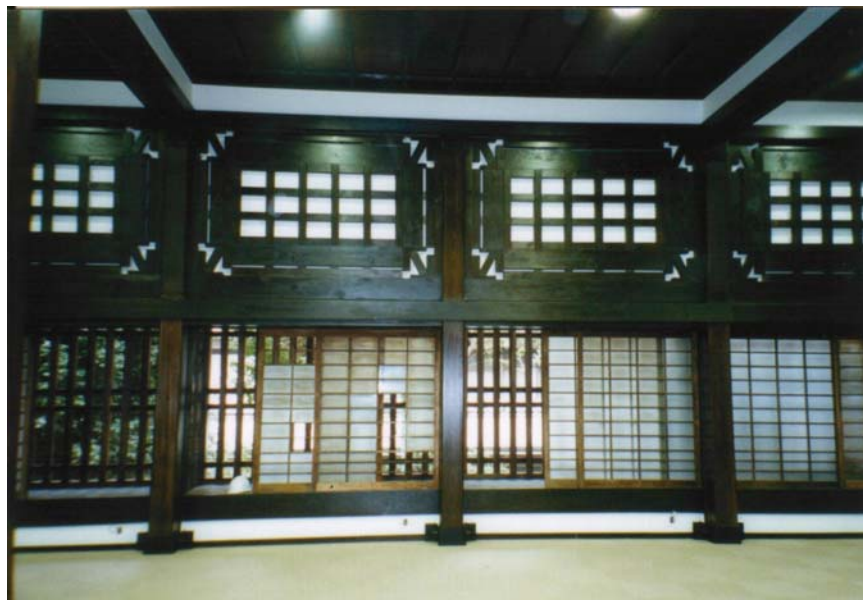
写真-7 意匠としての亀壁制震装置
