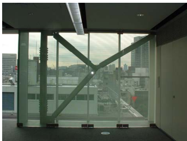
写真-5 6階大講堂前のトグル制震装置
